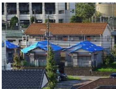
被害を受けた屋根の様子
