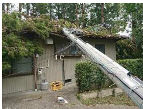
建物被害の様子
