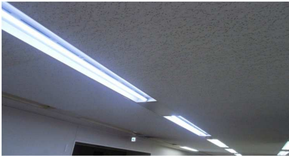
(図 5-2) 本庁舎における LED 照明の導入
