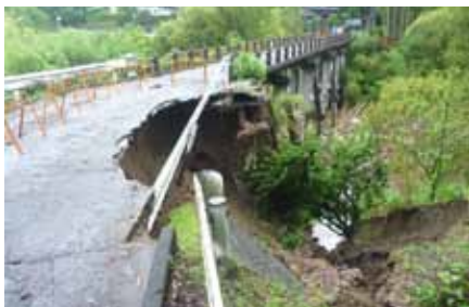
市道福岡・糸川線での崩落
