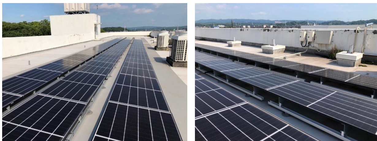
図4-1 市内小学校の太陽光発電設備
