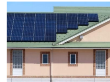
太陽光発電設備
