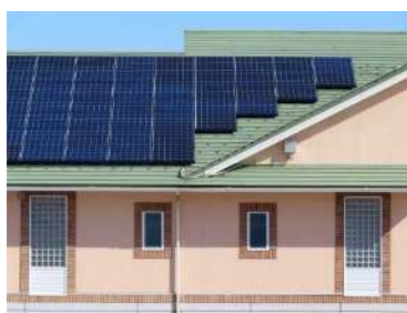
太陽光発電設備
