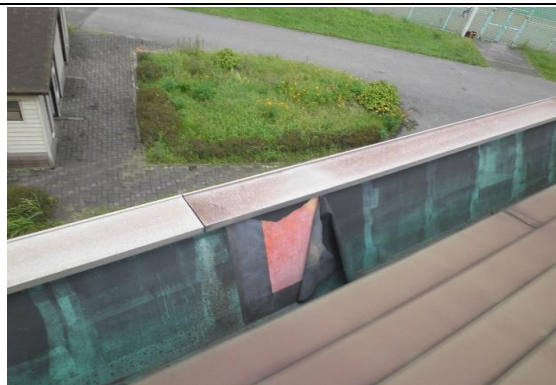
屋根防水シートの剥がれ
