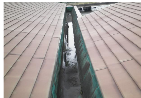
屋根防水シートの浮き
