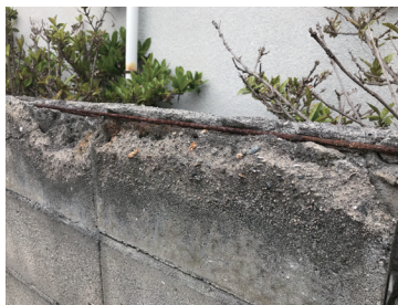
割れや鉄筋の露出がみられる塀
