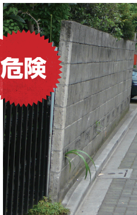
傾いている危ない塀
