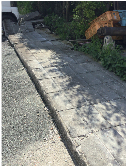
地震によりブロック塀が倒壊
