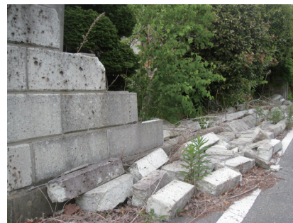
地震により石塀が倒壊
