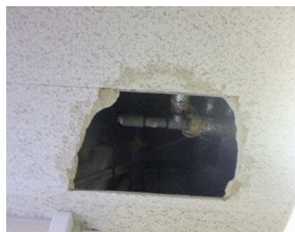
天井設備配管からの漏水
