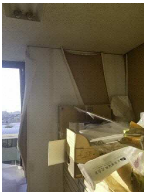
壁クロスの剥がれ
