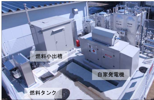
参考 自家発電機設備
