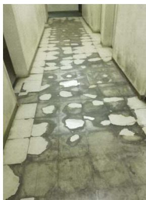
ビニル床タイルの剥がれ
