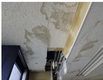
カーテンウォールからの漏水
