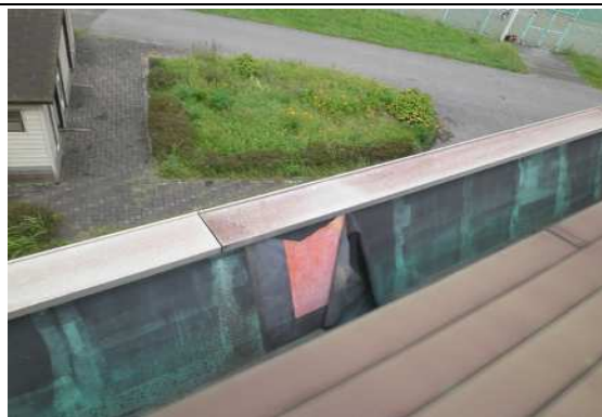
屋根防水シートの剥がれ
