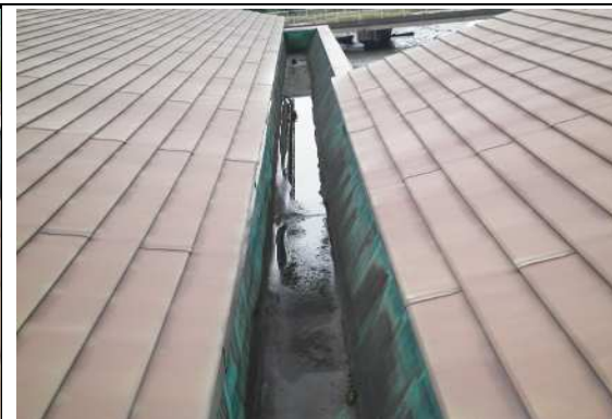
屋根防水シートの浮き
