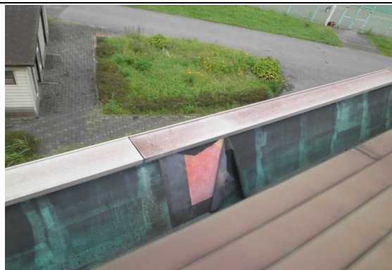
屋根防水シートの剥がれ
