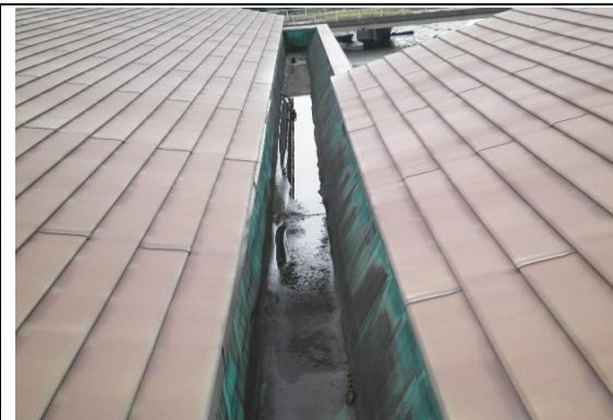
屋根防水シートの浮き
