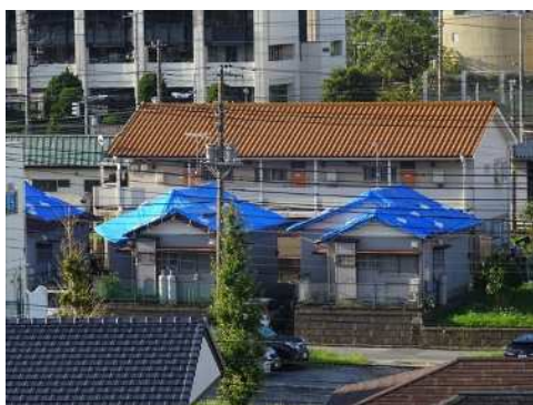
被害を受けた屋根の様子
