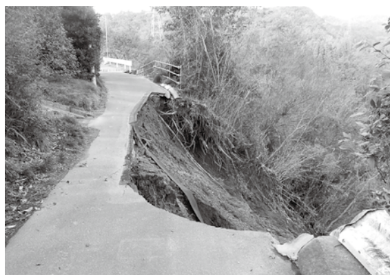
10月25日の大雨により路肩崩落した道路（加名盛地先）
