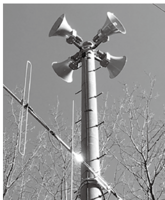
新設された防災行政無線 屋外拡声子局
