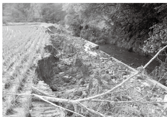
台風15号により護岸崩落した御腹川（川谷地先）
