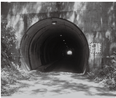
補修が予定されている清水トンネル
