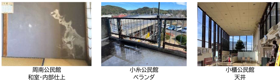
図2-2 老朽化の状況
