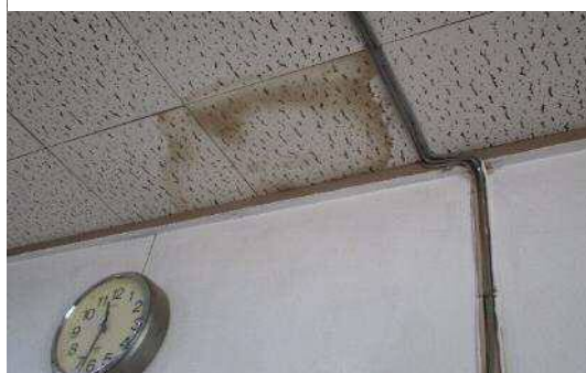
久保保育園（室内雨漏り）
