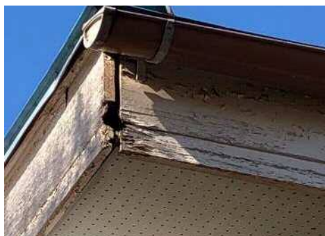
上湯江保育園（屋根劣化）
