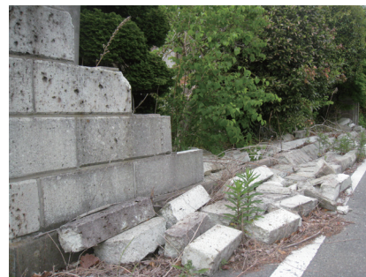
地震により石塀が倒壊
